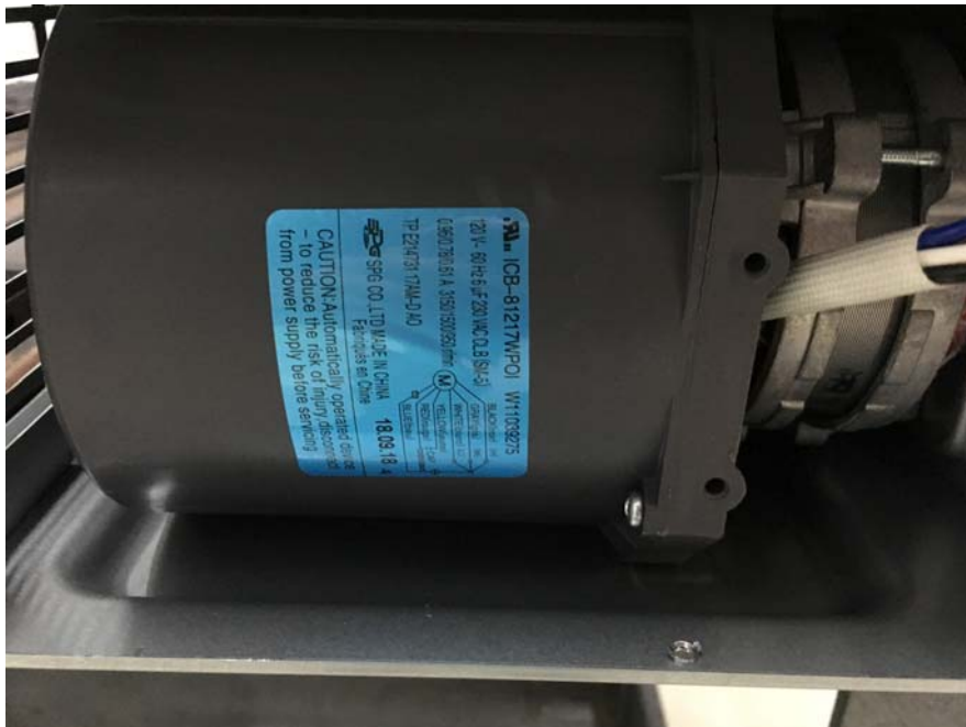
EUT – Fan 2 View
